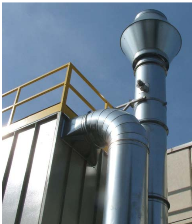
Fig. 20: piattaforma di lavoro non corretta: punto di campionamento con 2 bocchelli di prelievo posizionati a 90° e piattaforma di lavoro rettangolare.
