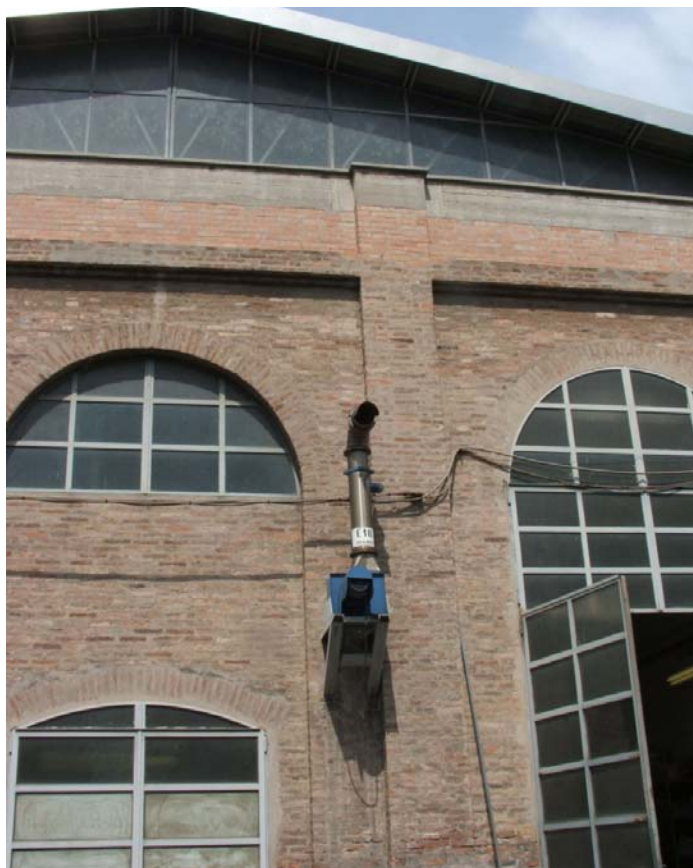
Fig. 9: posizione non corretta della bocca del camino: bocca posta sulla parete laterale dell'edificio aziendale.
