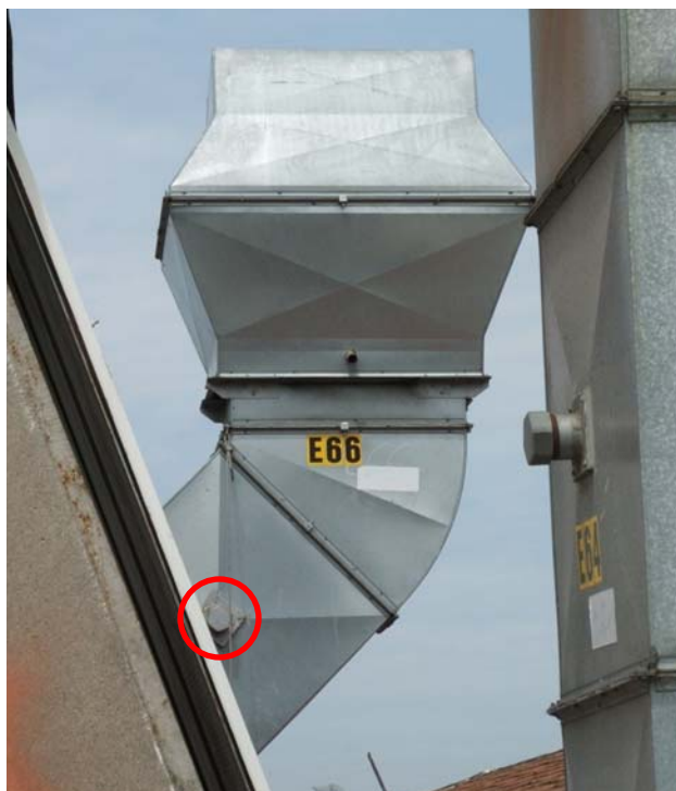
Fig. 3: emissione dotata di punto di campionamento posto in posizione non corretta: tratto rettilineo a valle del bocchello di campionamento troppo breve per la presenza di tratto curvo e con variazione delle dimensioni.
